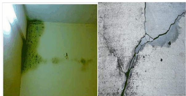
Hình 2. Tường bị thấm, nấm mốc, nứt do mao dẫn.
